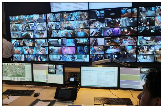
Photo 1 – Illustration d'un Poste de Commande Principal (PCP)
