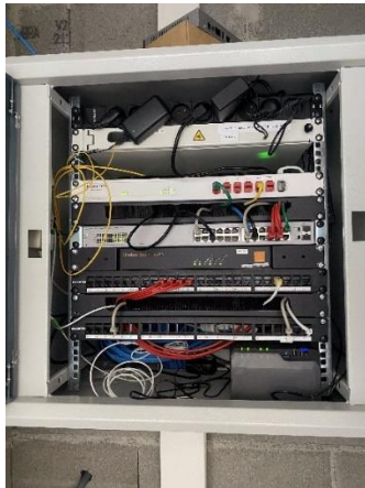
Baie de brassage couloir
