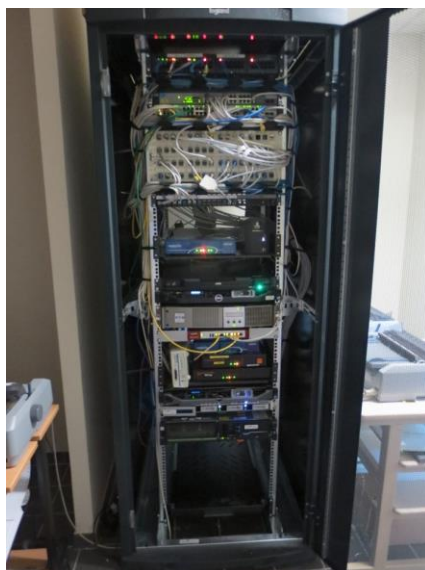
Figure 4 : Baie de brassage avec des équipements fixés dessus
