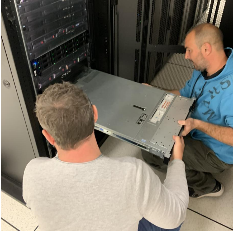
Figure 11 : Photo installation du serveur à Saint-Jérôme
