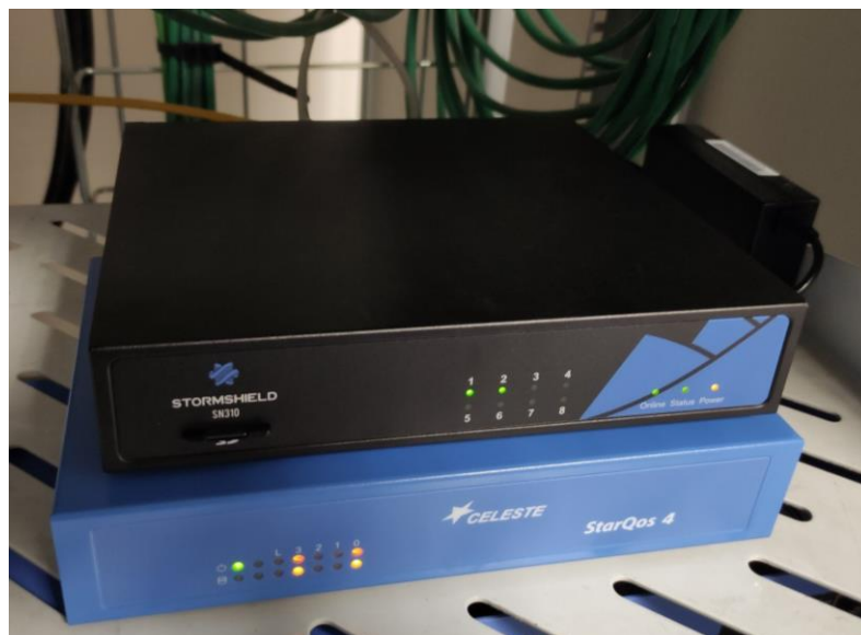
Figure 7 le Stormshield installer dans la baie serveur
