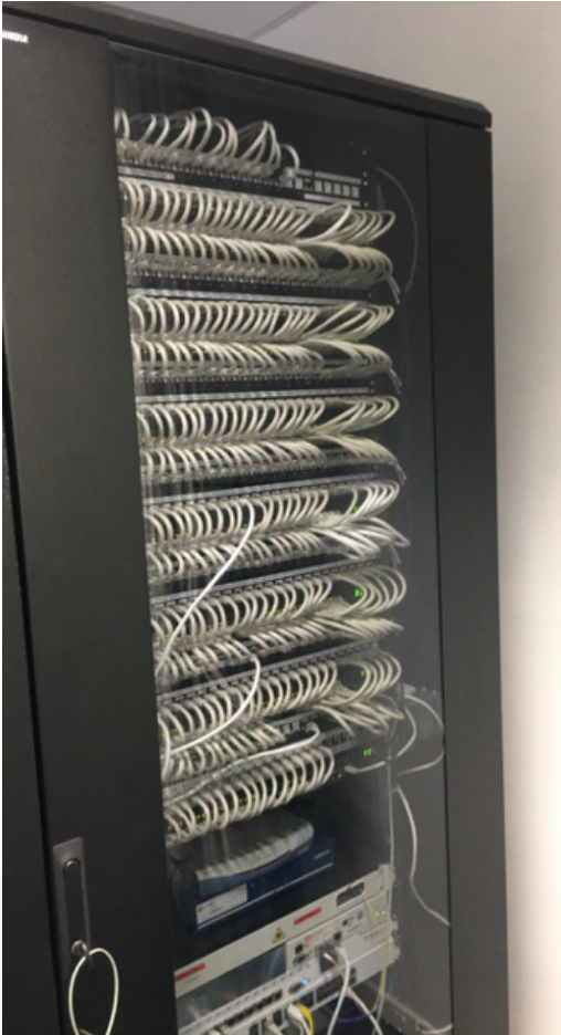
Figure 8 : baie informatique VoIP
