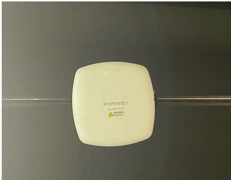
Figure 30 : FortAP 421E installée au plafond
