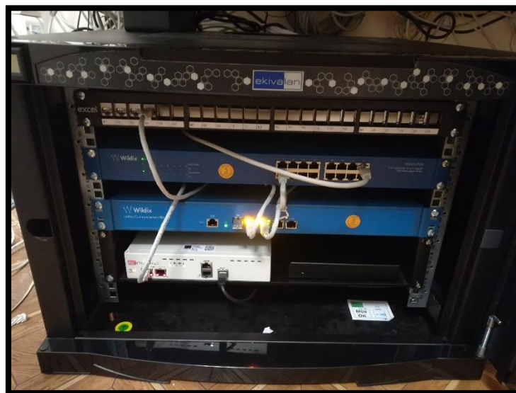
Figure 56 : baie de brassage Dallo
