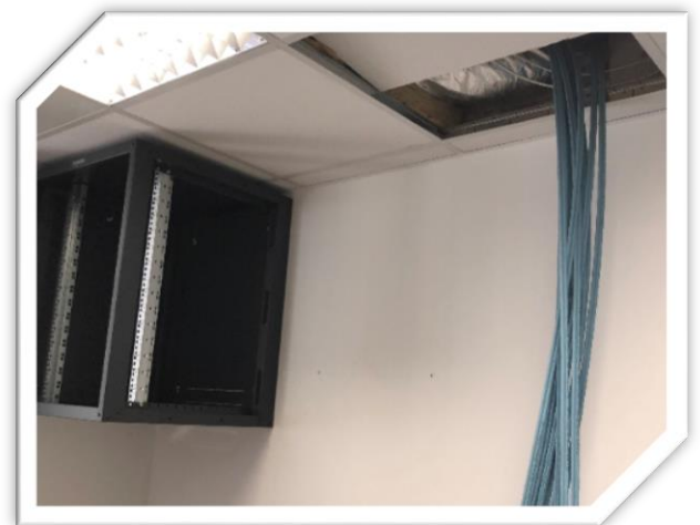
Figure 8 : câble dans les faux plafonds (coté baie)
