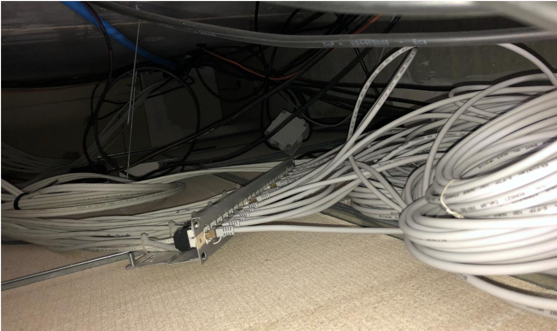
Figure 10 : Raccord prise réseau dans le faux plafond
