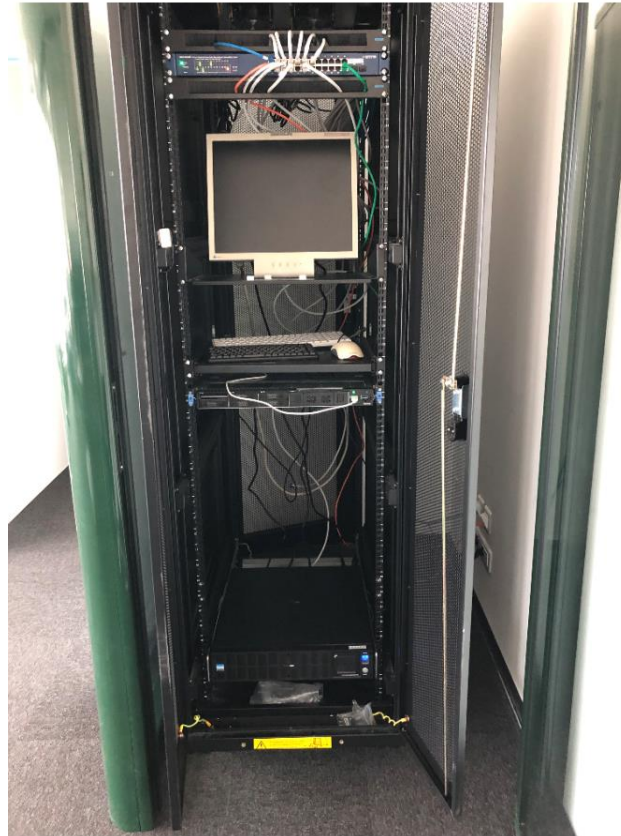
Figure 14 : Baie serveur finalisée
