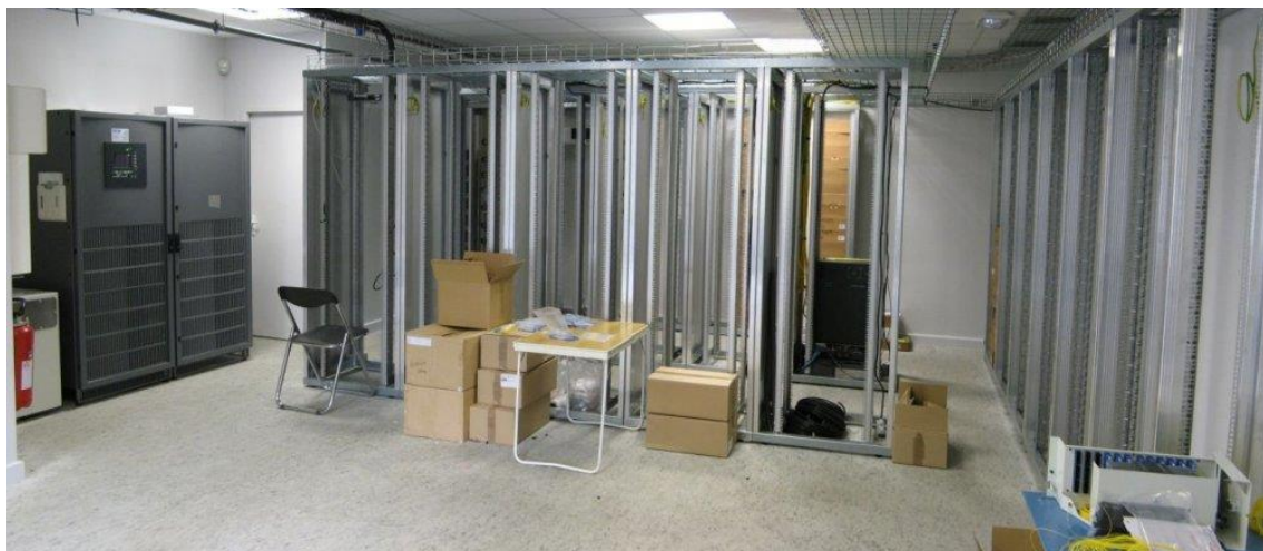
Figure 4 : intérieur d'un NRO
