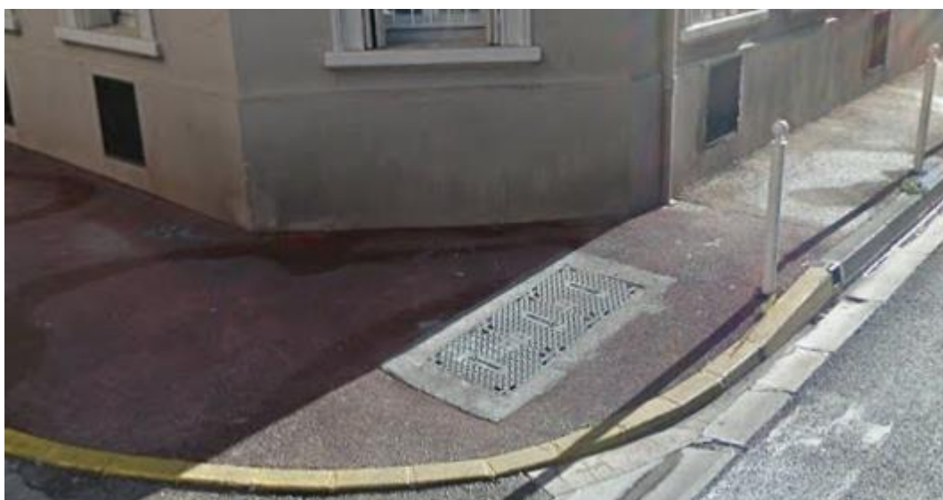
Figure 5 : chambre télécom sur trottoir à Toulon
