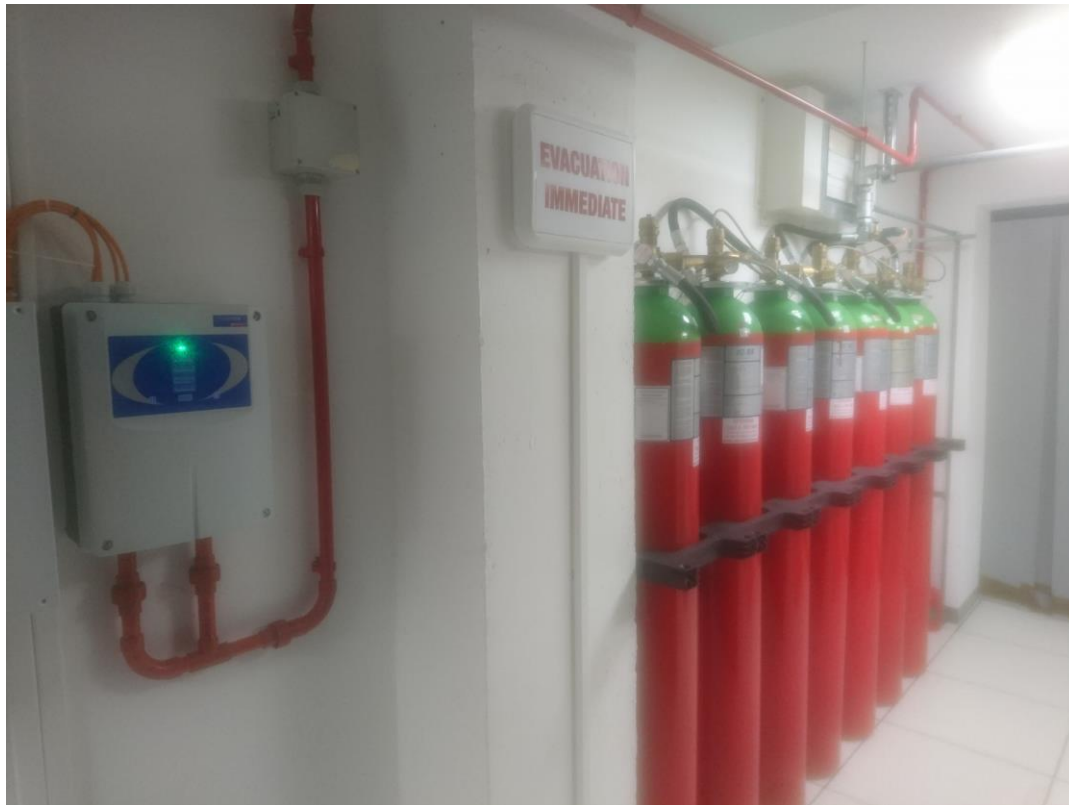
Figure 13 : Système d'extinction automatique d'incendie par gaz inerte
