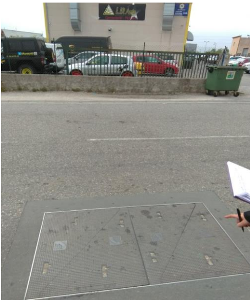
Chambre de tirage
