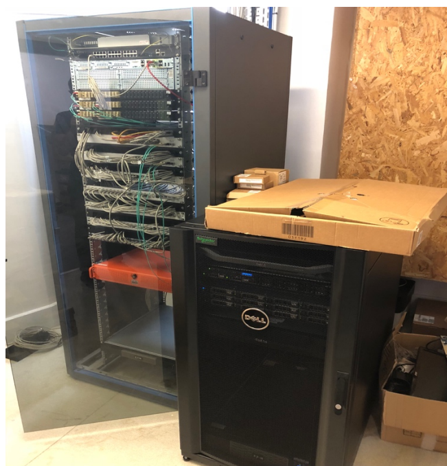
Figure 14 : Baies de brassage Cap Vert Énergie
