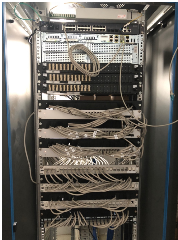
Figure 11 : Baie de brassage principale
